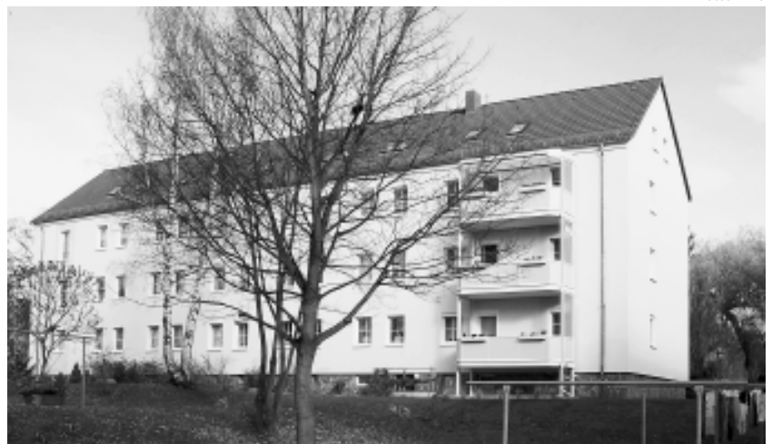
Der Anbau der Balkone in der Clara-Zetkin-Straße 1, 3 und 5 (Bild oben) sowie der Straße der Jugend 1 und 3 (Bild unten) wurde termingerecht abgeschlossen.
