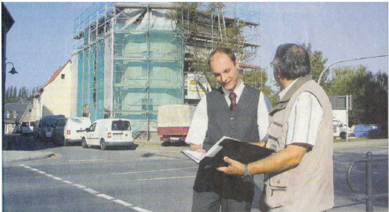
Ronneburgs Stadteingang von Gera aus wird um ein Fleckchen schöner. Das ortsbildprägende Gebäude Geraer Straße 2 wird saniert und modernisiert, davor Geschäftsführer Michael Heidrich (l.) und Sanierungsbeauftragter Joachim Schreiber. (Foto: OTZ/ Baumann)
