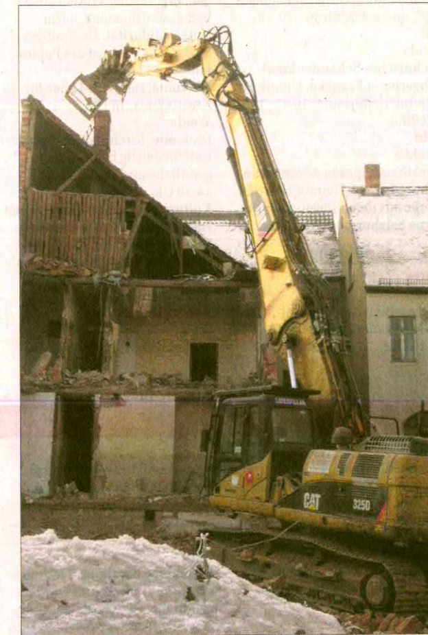
Der Abrißbagger frisst sich in die Hintergebäude am Ronneburger Markt. Bis etwa Ende März soll der Abbruch abgeschlossen sein. Danach entstehen hier Wohnungen und ein Seniorenheim. (Foto: OTZ/Katja Schmidtke)
