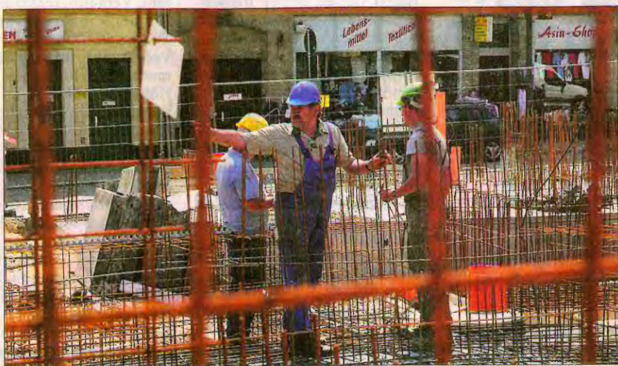
Blick durch Metallstreben: Die Bauarbeiter bereiten für den Neubau Markt 15 in Ronneburg die Stahlbeton-Wände vor. Foto: Katja Schmidtke
